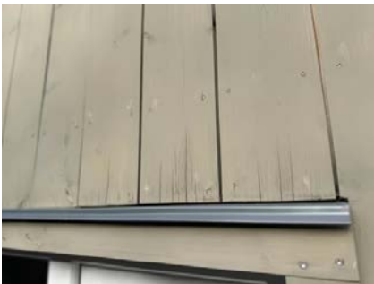
Soltørket og oppsprukket panel.
