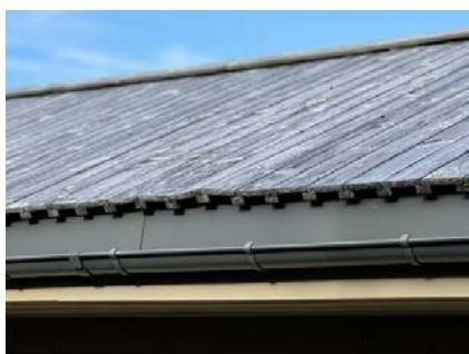
Bordtak har ujevnheter som trenger vedlikehold.
