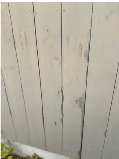
Det er behov for noe overflatebehandling.
