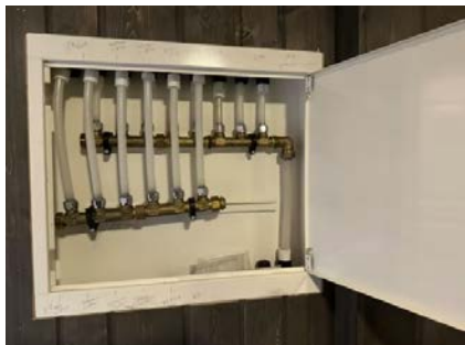
Vannlåsskap i bod.
