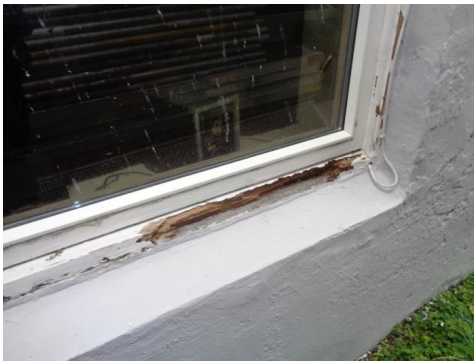
Ødelagt/dårlig karm til vindu.
