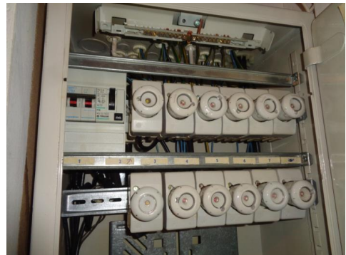
Sikringsskap med skrusikringer i 2. etasje.
