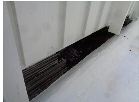
Stor åpning mellom gjerde og dekke.
