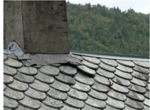
Noe løs stein ved pips.
