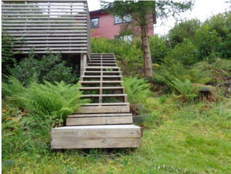
Det er ikke rekkverk i trappen for å hindre fallskader.
