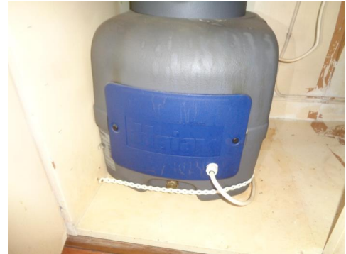
Liten bereder på kjøkken i kjeller.
