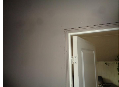
Det mangler dørlister til noen dører.
