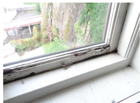
Elder vinduer som må skiftes.
