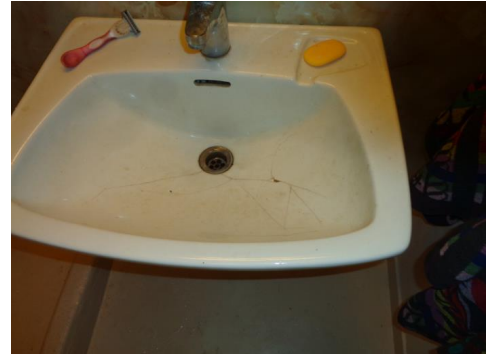
Sprekk i servant.
