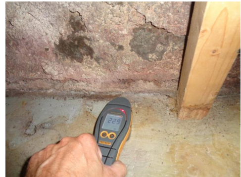
Fuktverdier målt på betongdekke i bod.
