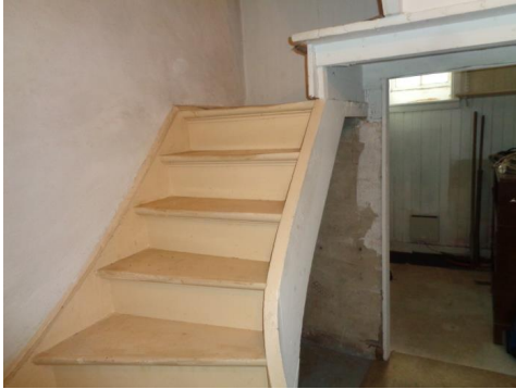
Innvendige trapper uten sikring.
