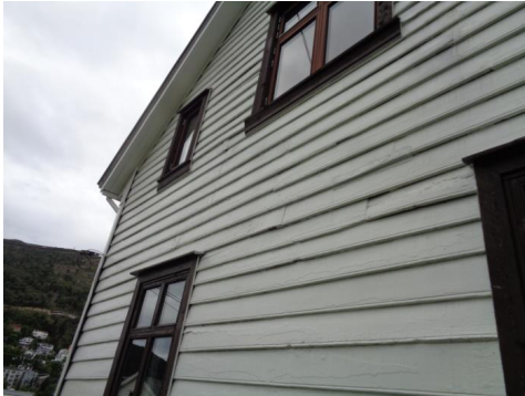
Noe oppsprekk i kledning. Eldre kledning.
