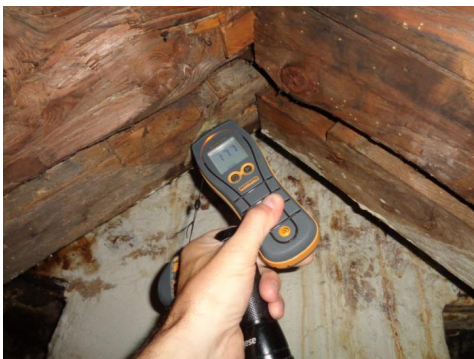
Noe forhøyet fuktverdier på tresperr.
