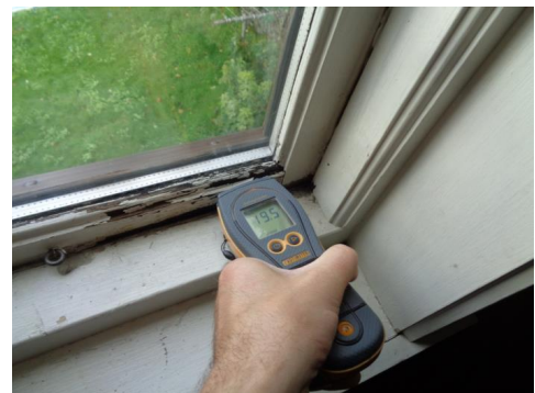
Noe forhøyet fuktverdier i trekramer på noen vinduer.
