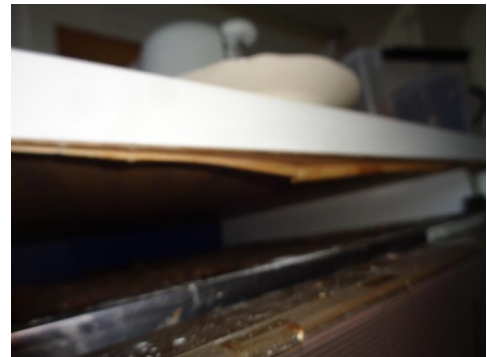
Slitasje på underside av benkeplater.
