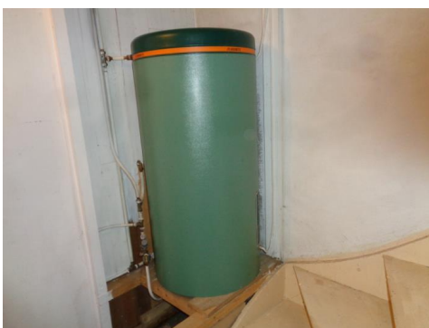
Eldre varmtvannsbereder i trapperom.
