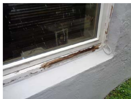
Ødelagt/dårlig karm til vindu.
