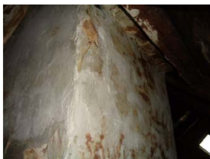
Sotrenn og noe løs puss på pipe loft.
