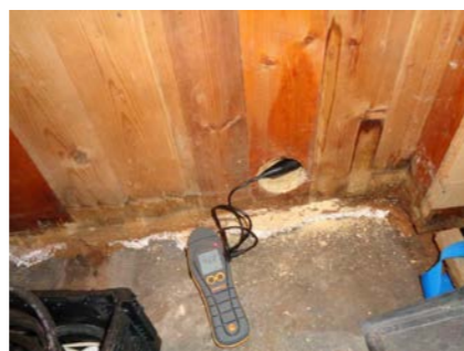
Det ble målt høye fuktverdier i trevirke i kjellerrom mot terreng.
