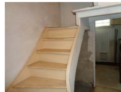
Innvendige trapper uten sikring.
