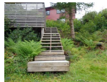
Det er ikke rekkverk i trappen for å hindre fallskader.
