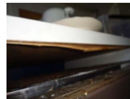
Slitasje på underside av benkeplater.
