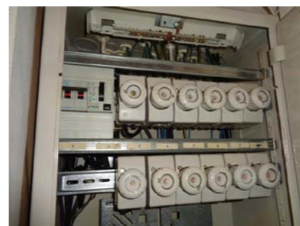
Sikringsskap med skrusikringer i 2. etasje.
