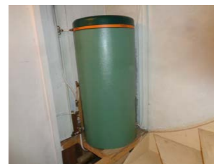
Eldre varmtvannsbereder i trapperom.
