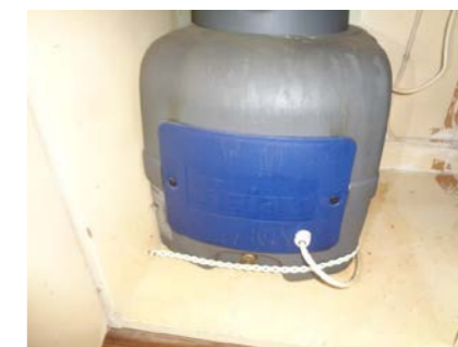
Liten bereder på kjøkken i kjeller.
