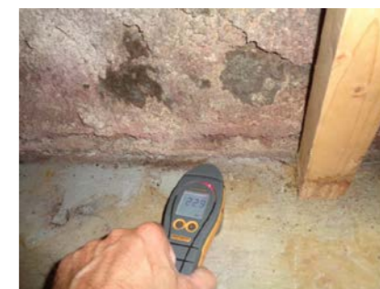
Fuktverdier målt på betongdekke i bod.
