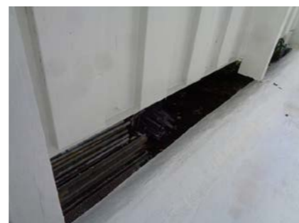
Stor åpning mellom gjerde og dekke.
