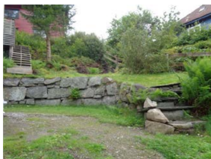
Det mangler rekkverk/annen sikring på forstøtningsmuren(e) ut ifra dagens krav.
