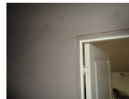
Det mangler dørlister til noen dører.
