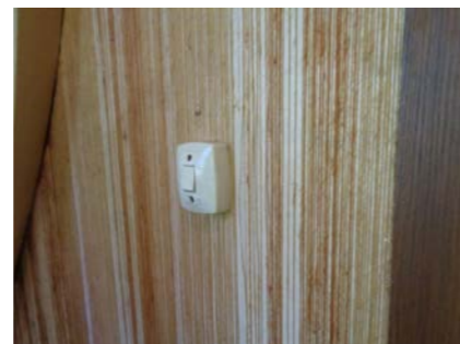
Eldre el-anlegg i boligen.
