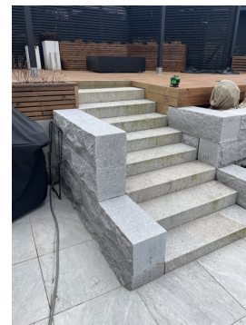
Mangler rekkverk ved trapp og rundt terrasse
