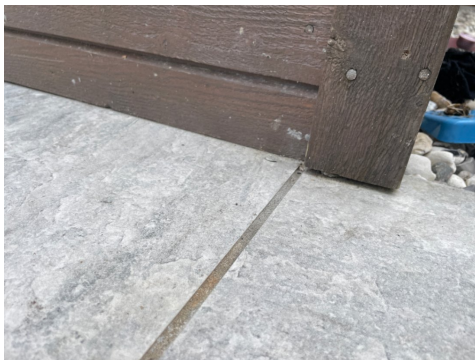
Kledning helt ned mot terrasseheller
