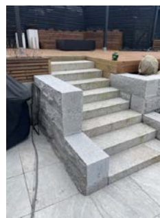
Mangler rekkverk ved trapp og rundt terrasse
