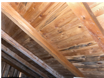
Loft, skjolder i undertak
