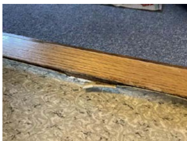
Skader i belegg (oppkant ved dør mot gang)
