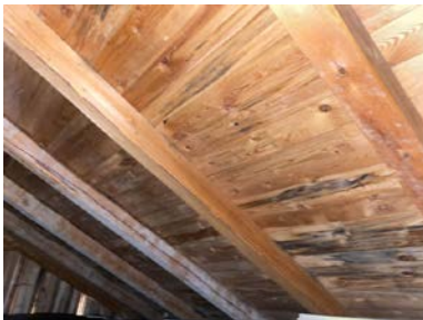
Loft, skjolder i undertak
