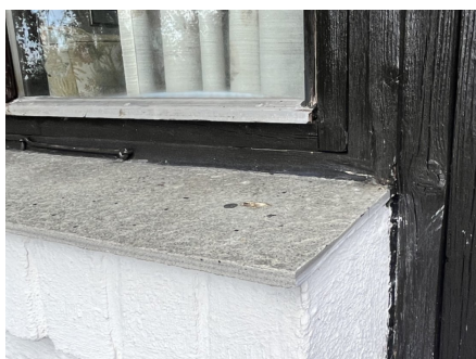
Vindu helt ned på sålebank, slitt utside.
