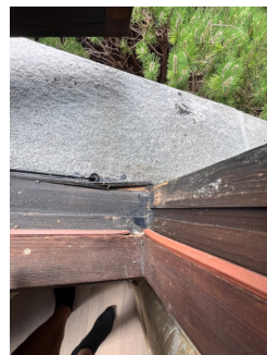
Skade på karm og kort pakning
