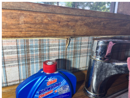
Bruks slitasje på vegg over benkeplate
