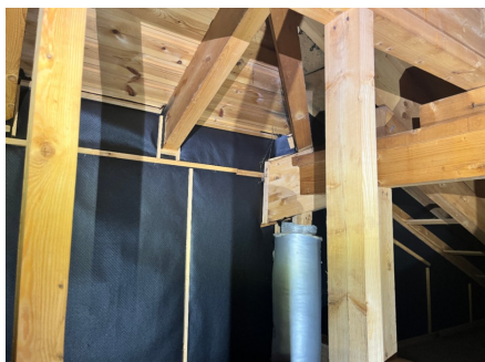
Ventilasjonsskanaler på kaldloft
