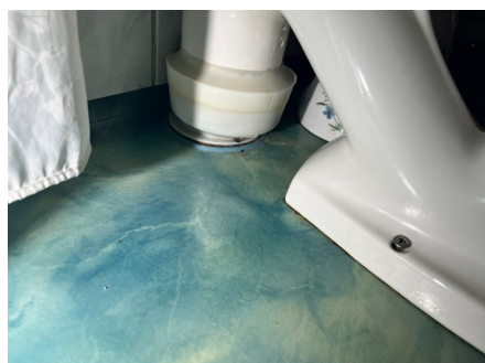
Lav oppbrett rundt rør.
