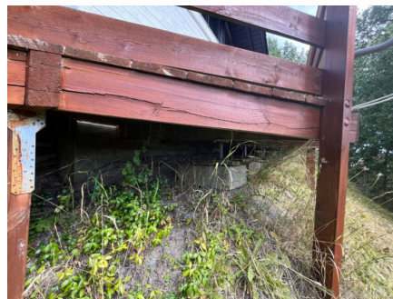
Sprekker i trevirket
