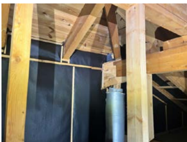
Ventilasjonskanaler på kaldloft
