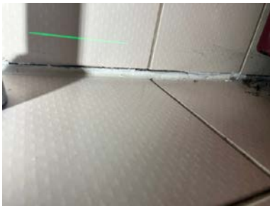
Sprekker i elastisk fuge
