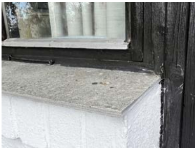
Vindu helt ned på sålebank, slitt utside.
