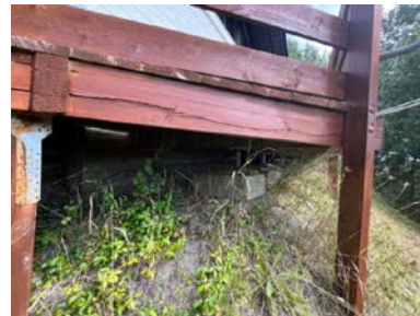
Sprekker i trevirket
