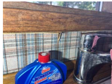
Bruks slitasje på vegg over benkeplate
