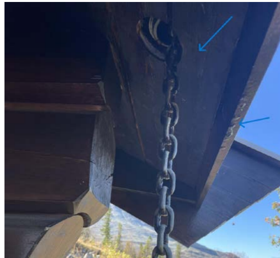
Det registreres vann fra nedløp i undertak og front bord.
