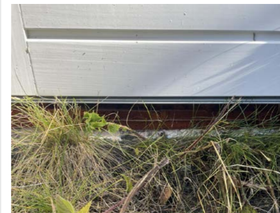
Det mangler beslag under terrassedør.
