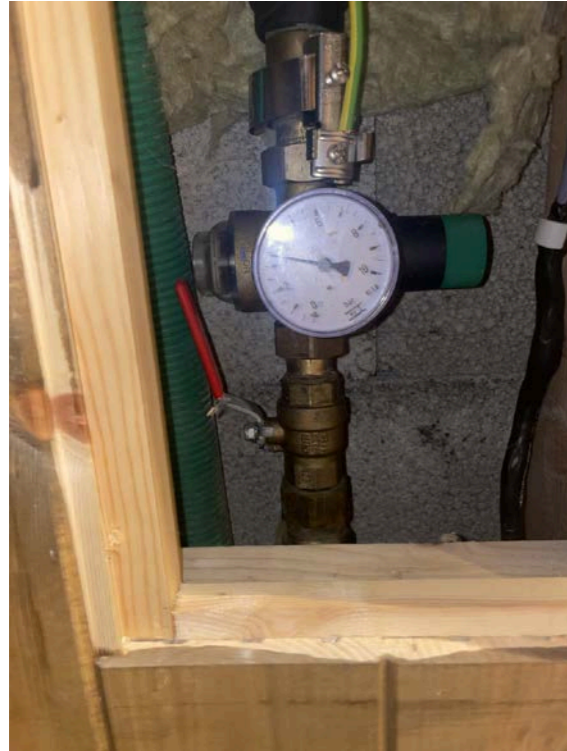
Stoppekran i utforet vegg, med trykk reduksjonsventil.
