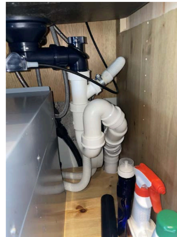
Ikke registrert lekkasje. Det blir ikke registrert Waterguard i forbindelse med vann installasjonene.
