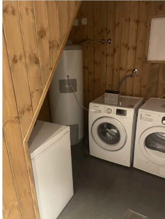
Varmtvannsbereider på teknisk rom det er opplegg for vaskemaskin i rommet.
