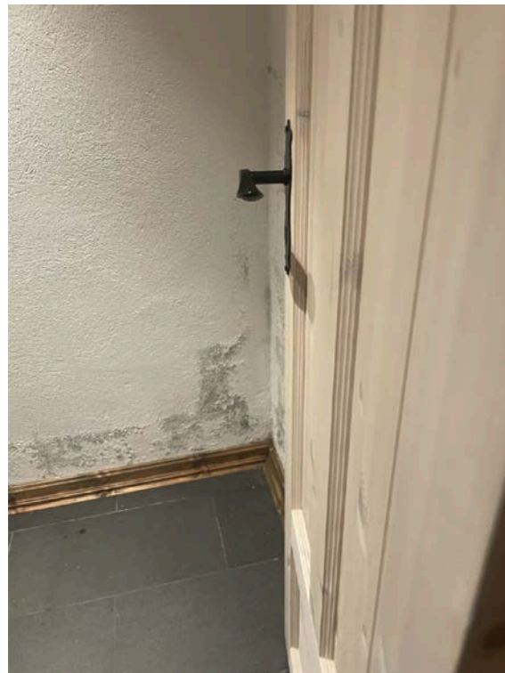
Salt/kalkutslag på yttervegg teknisk rom
