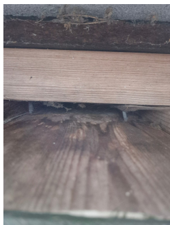
Mangler musesperre bak kledningsbord.
