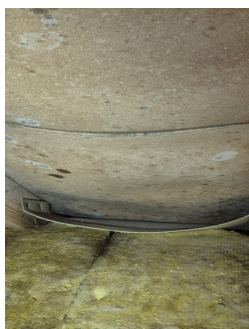
Liten luft i nedre del av konstruksjon.
