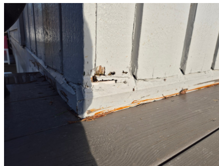
Råte i kledningsbord.
