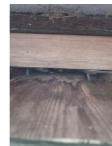
Mangler musesperre bak kledningsbord.
