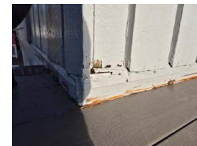
Råte i kledningsbord.
