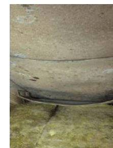
Liten luft i nedre del av konstruksjon.
