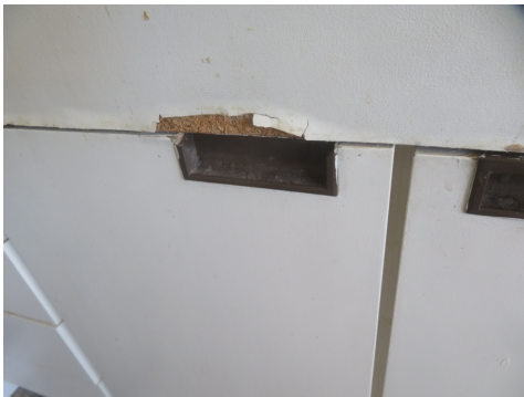
Skader på innredning.
