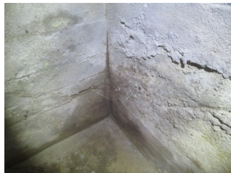
Saltutslag i kjellervegger.
