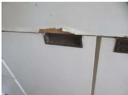
Skader på innredning.
