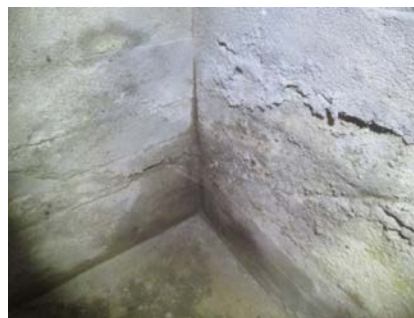
Saltutslag i kjellervegger.
