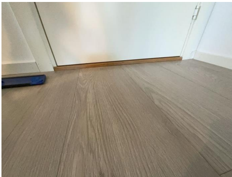
Spalte under dør.
