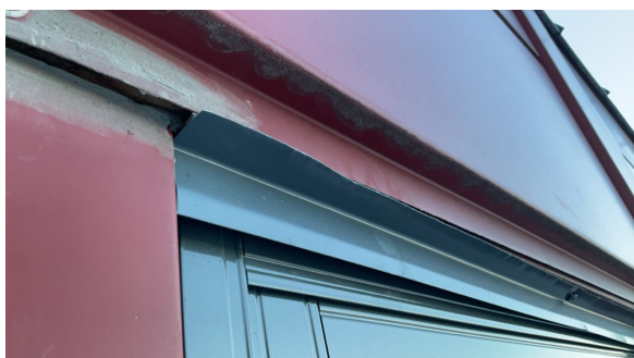
Løst beslag over vindu
