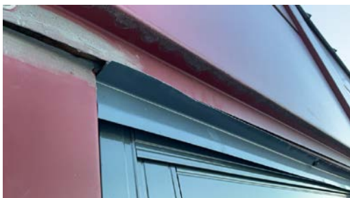
Løst beslag over vindu
