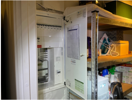
Sikringsskap står i bod.
