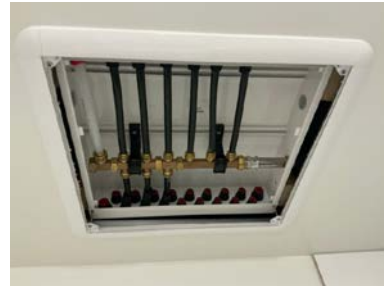
Rør i rør skap plassert i tak på bad/vaskerom.
