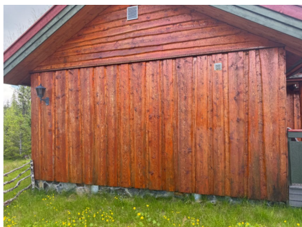
Noe slitasje i nedre del av panel
