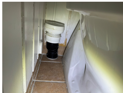
Durgoverventil montert på bad
