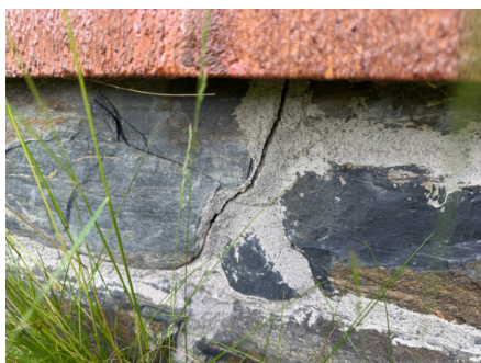
Sprekker ved fasadestein utvendig på grunnmur
