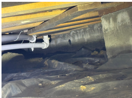
Lokalt motfall på avløpsrør i krypkjeller
