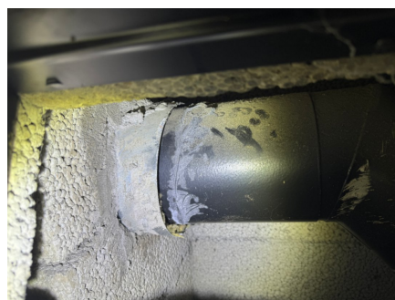
Ikke montert tettesnor
