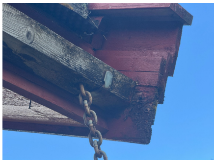
Slitasje i nedre del av dekkbord
