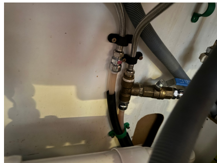
Ikke montert tettemuffe i enden av ytterrør
