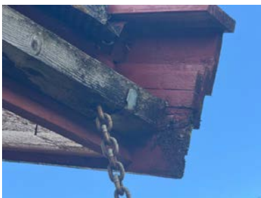
Slitasje i nedre del av dekkbord
