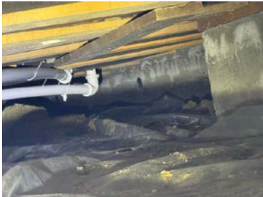
Lokalt motfall på avløpsrør i krypkjeller
