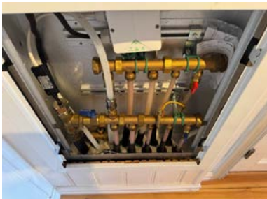
Vannskap plassert i gang
