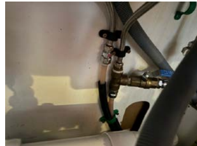
Ikke montert tettemuffe i enden av ytterør
