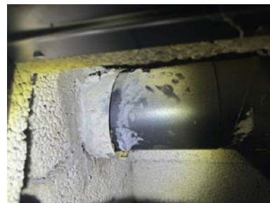
Ikke montert tettesnor
