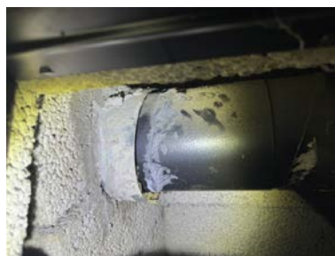
Ikke montert tettesnor
