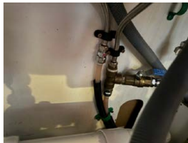
Ikke montert tettemuffe i enden av ytterør
