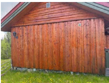
Noe slitasje i nedre del av panel
