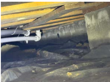
Lokalt motfall på avløpsrør i krypkjeller
