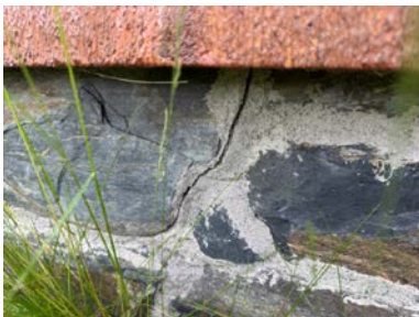
Sprekker ved fasadestein utvendig på grunnmur
