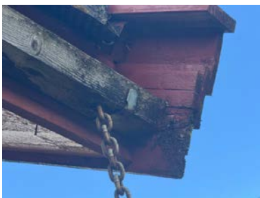
Slitasje i nedre del av dekkbord
