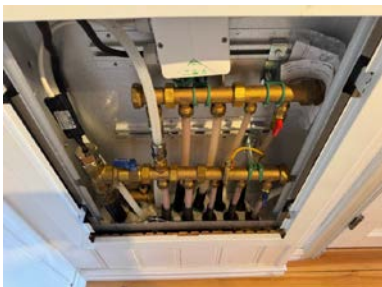
Vannskap plassert i gang
