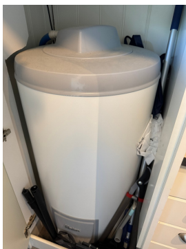
Varmtvannstank i kjøkkenskap.
