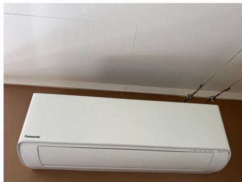
Varmepumpe med uttak i stue.
