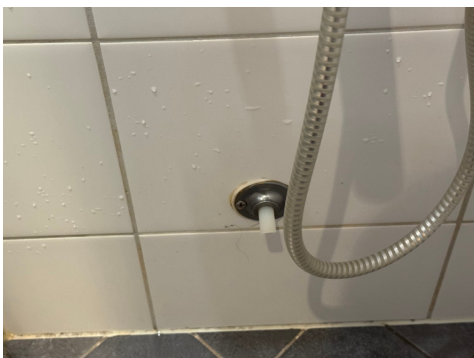
Rørgjennomføring i dusjsone (ukurant løsning). Løsning bør utbedres v/ en eventuell oppgradering av bad.
