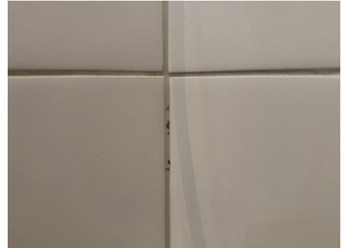
Svertesopp i silikonfuge i dusjsone.
