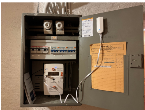
Sikringsskap i fellesarealer.
