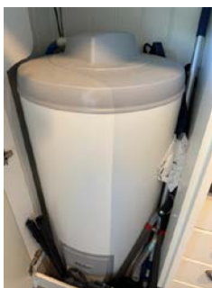
Varmtvannstank i kjøkkenskap.
