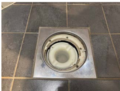
Plastsluk i dusjsone.
