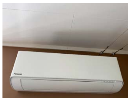
Varmepumpe med uttak i stue.
