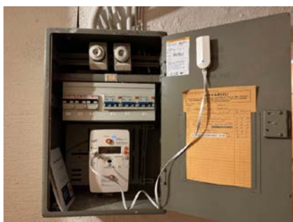
Sikringsskap i fellesarealer.
