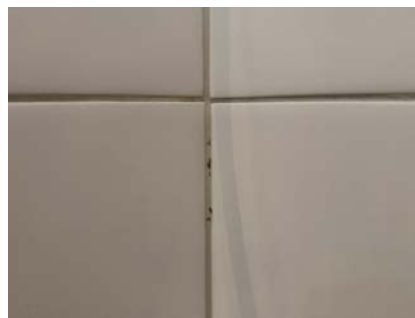
Svertesopp i silikonfuge i dusjsone.
