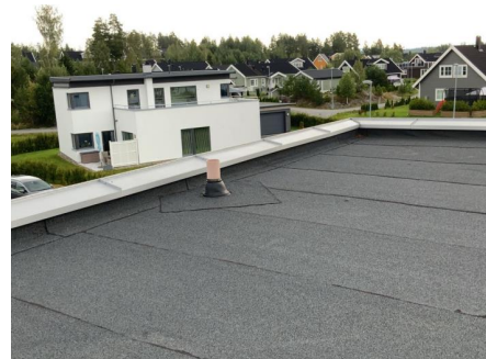
Det er ikke etablert luftehatt på rør. Dette bør utbedres med tanke på nedbør.
