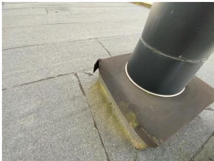
Noe løs skjøt på hjørne av overdekking til pipe.
