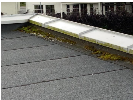
Noe synlig mose på 1 side.
