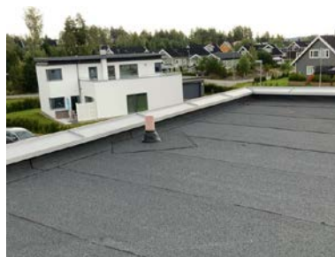
Det er ikke etablert luftehatt på rør. Dette bør utbedres med tanke på nedbør.
