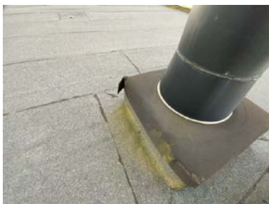
Noe løs skjøt på hjørne av overdekking til pipe.
