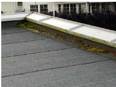
Noe synlig mose på 1 side.
