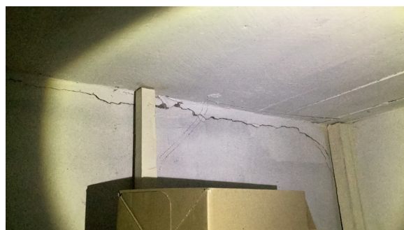
Eksempel på sprekk i grunnmur på innside.
