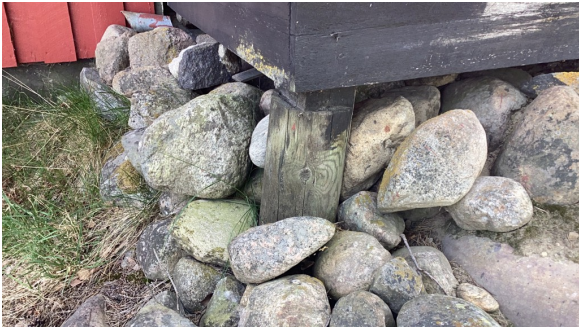
Eksempel på skjevt fundament.
