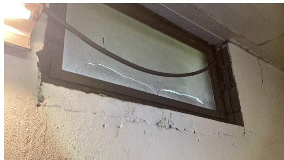
Kjellervindu med sprekk i glass.
