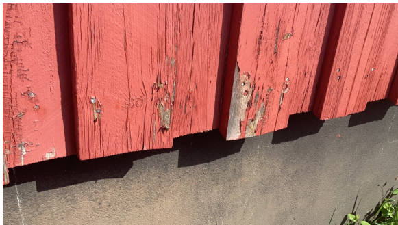
Eksempel på slitasje.
