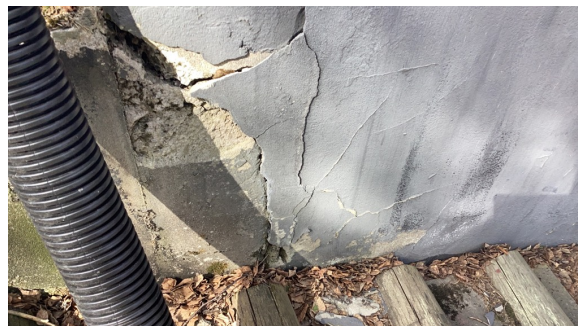
Avskaling på grunnmur
