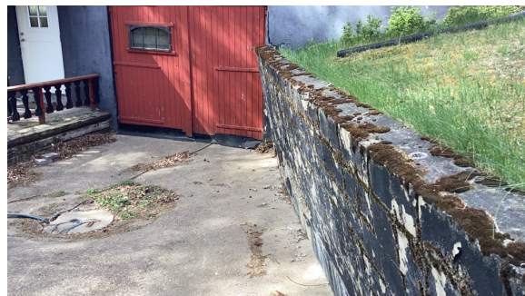
Kraftig helning på mur
