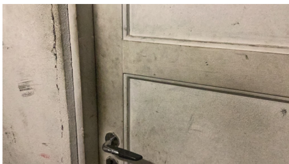
Eksempel på slitasje og misfarging i kjeller.
