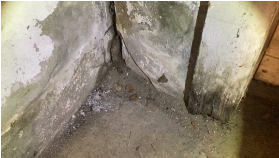
Det ser ut som det har forekommet innsig av vann og sand ved port.
