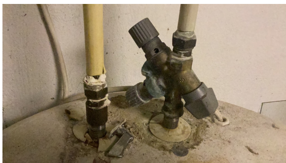
Korrosjon på skjøter.
