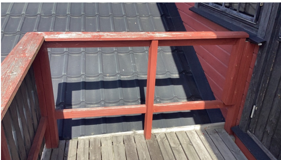
Manglende kledning i rekkverk på balkong.
