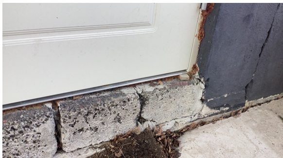
Det er ikke ferdige tilslutninger rundt dør til hybel.
