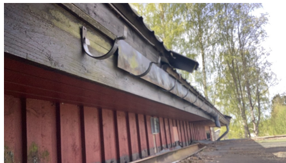
Det er ikke beslag og takrenne over garasje.
