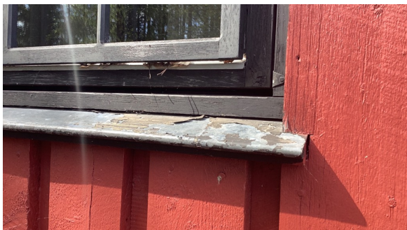
Eksempel på slitasje.
