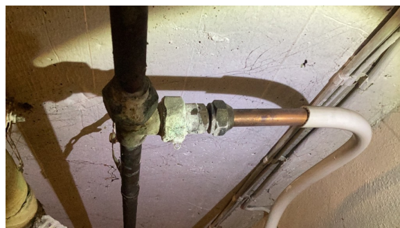
Eksempel på drypplekkasje.
