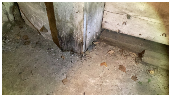
Råte i portomramming.
