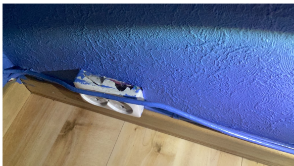
Eksempel på skade på stikkontakt.
