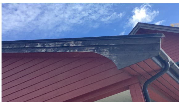
Eksempel på slitasje.
