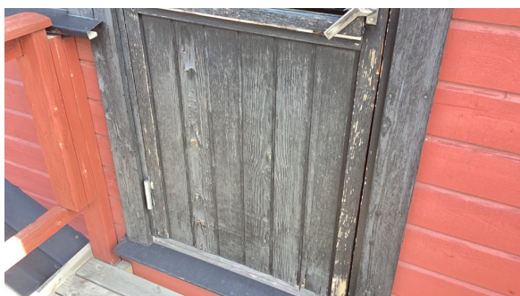
Slitasje på verandadør.
