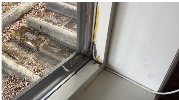
Eksempel på slitasje.
