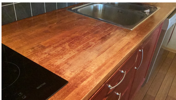
Eksempel på slitasje.
