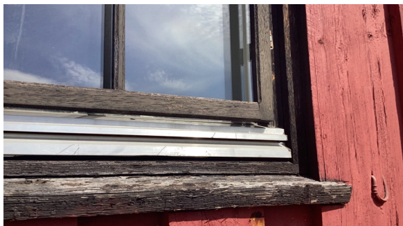
Eksempel på slitasje.
