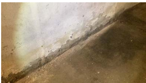
Eksempel på saltutslag og avskaling.
