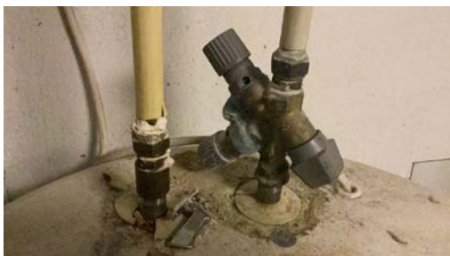
Korrosjon på skjøter.
