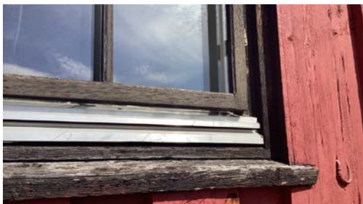
Eksempel på slitasje.
