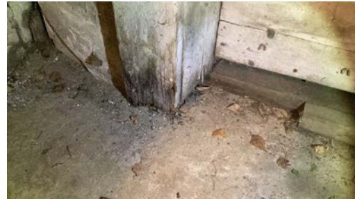
Råte i portomramming.
