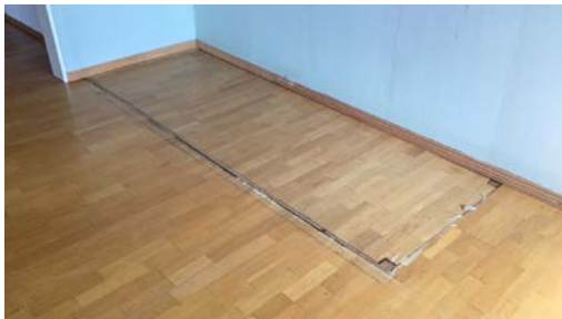
Trappeutsparing er tettet igjen
