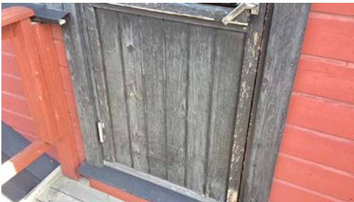
Slitasje på verandadør.
