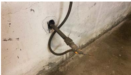
Vanninntak i garasje.
