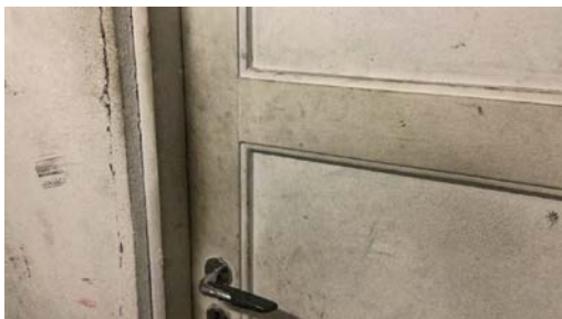
Eksempel på slitasje og misfarging i kjeller.
