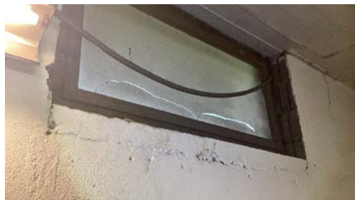
Kjellervindu med sprekk i glass.
