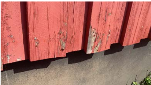
Eksempel på slitasje.
