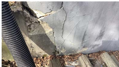
Avskaling på grunnmur
