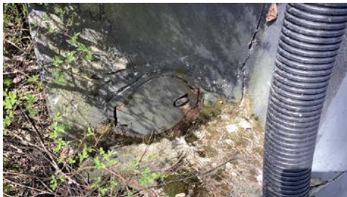
Sotluke på utvendig pipe.
