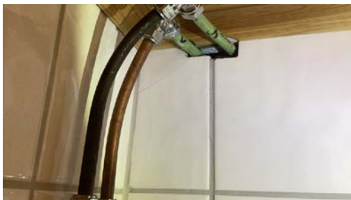
Sprekk i flis ved vanninntak.
