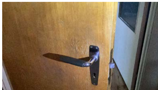
Eksempel på slitasje.
