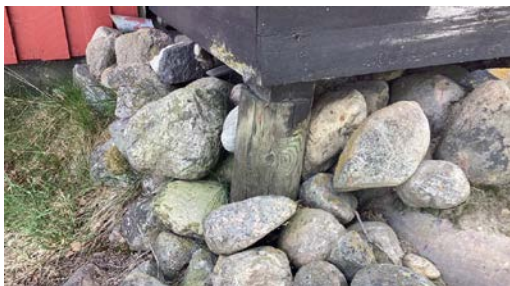
Eksempel på skjevt fundament.
