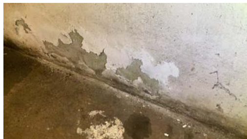
Eksempel på saltutslag og avskaling.
