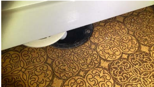
Sluk av plast med klemring.
