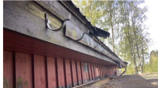
Det er ikke beslag og takrenne over garasje.
