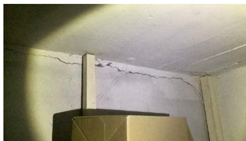
Eksempel på sprekk i grunnmur på innside.
