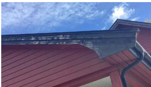
Eksempel på slitasje.
