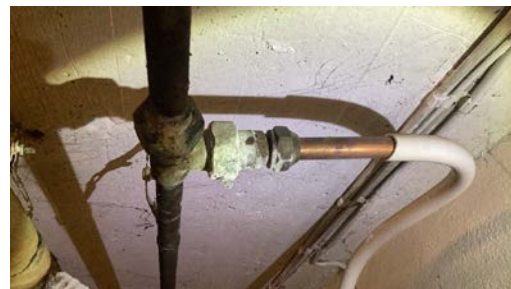
Eksempel på drypplekkasje.
