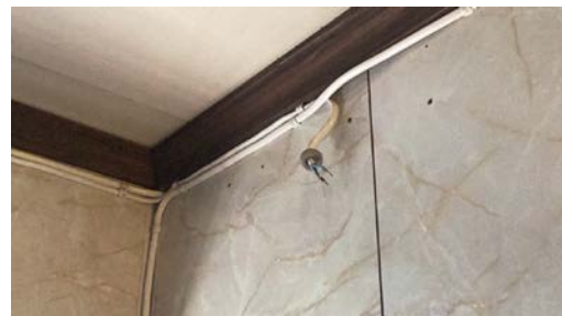
Løs ende på kabel.
