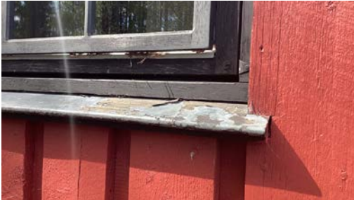
Eksempel på slitasje.
