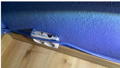
Eksempel på skade på stikkontakt.
