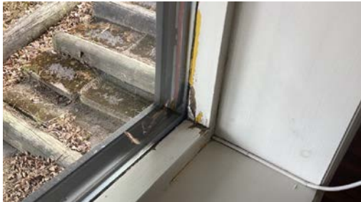
Eksempel på slitasje.
