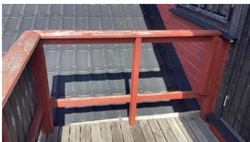
Manglende kledning i rekkverk på balkong.
