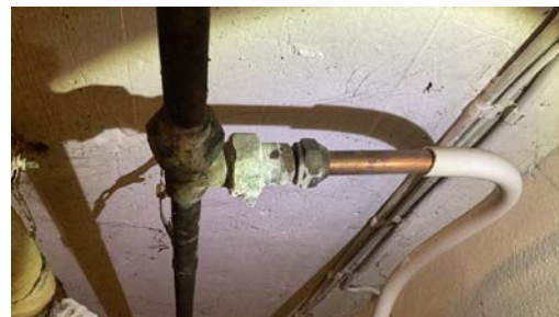
Eksempel på drypplekkasje.
