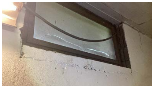
Kjellervindu med sprekk i glass.
