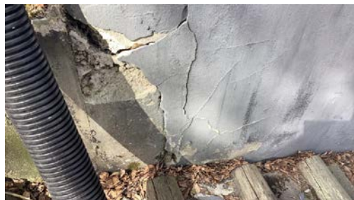
Avskaling på grunnmur
