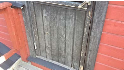
Slitasje på verandadør.
