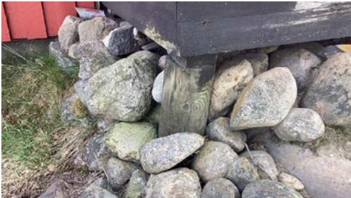
Eksempel på skjevt fundament.
