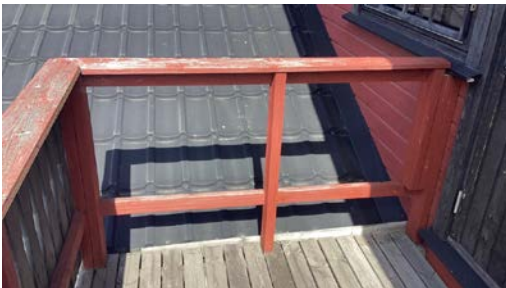
Manglende kledning i rekkverk på balkong.
