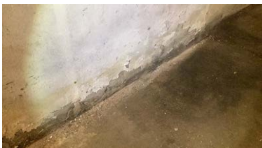
Eksempel på saltutslag og avskaling.
