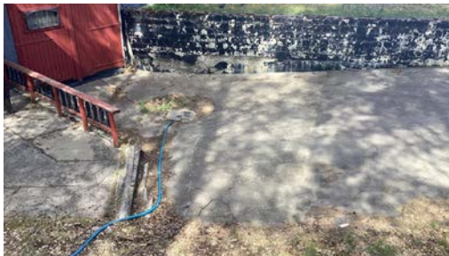
Fall på terreng inn mot bygget.
