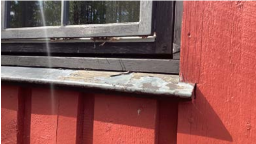
Eksempel på slitasje.
