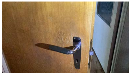
Eksempel på slitasje.
