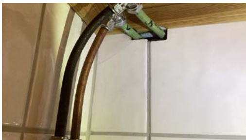
Sprekk i flis ved vanninntak.
