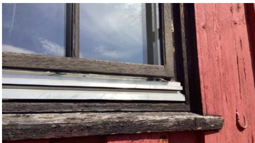
Eksempel på slitasje.
