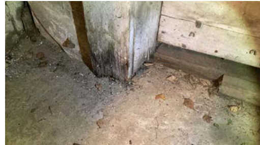
Råte i portomramming.
