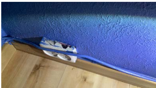
Eksempel på skade på stikkontakt.
