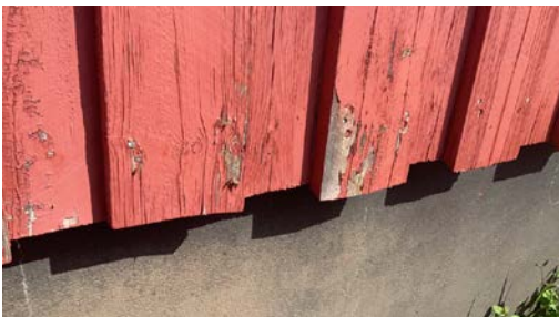
Eksempel på slitasje.
