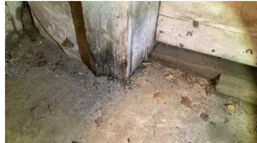
Råte i portomramming.
