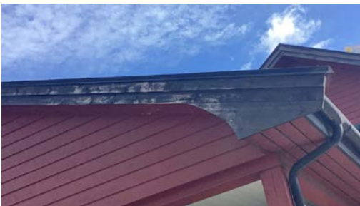
Eksempel på slitasje.
