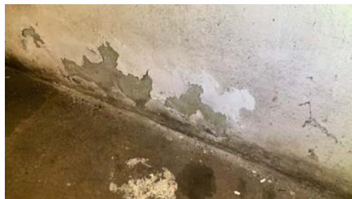
Eksempel på saltutslag og avskaling.
