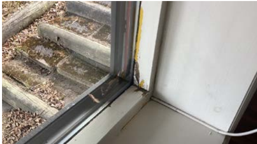
Eksempel på slitasje.
