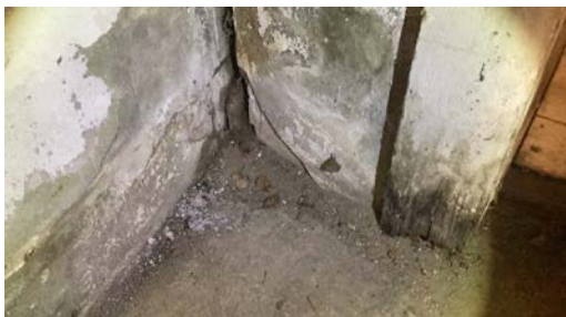
Det ser ut som det har forekommet innsig av vann og sand ved port.
