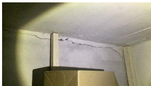
Eksempel på sprekk i grunnmur på innside.
