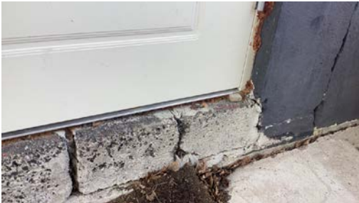
Det er ikke ferdige tilslutninger rundt dør til hybel.
