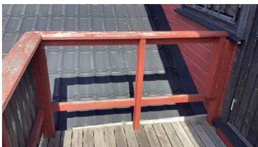
Manglende kledning i rekkverk på balkong.
