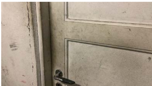
Eksempel på slitasje og misfarging i kjeller.
