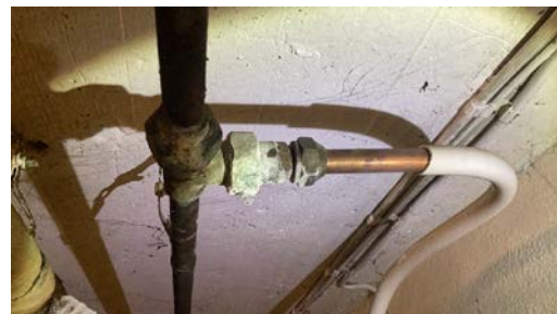
Eksempel på drypplekkasje.
