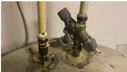
Korrosjon på skjøter.
