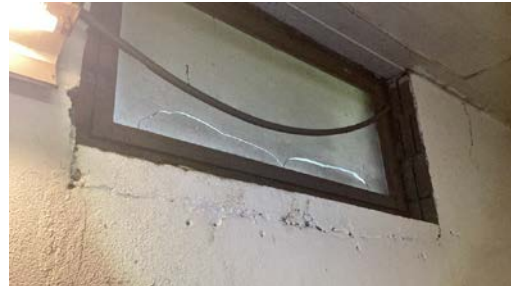
Kjellervindu med sprekk i glass.
