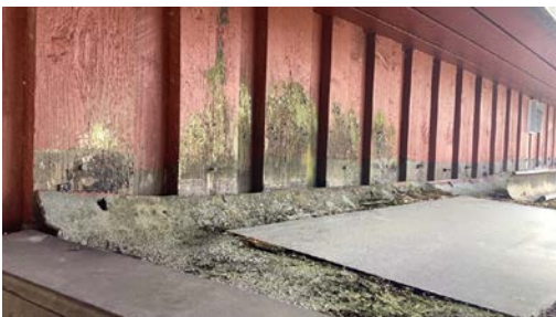
Fuktpåkjeninger på kledning mot garasje. Lokal råte kan finnes.
