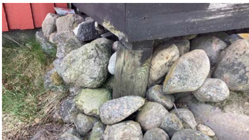
Eksempel på skjevt fundament.
