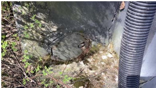
Sotluke på utvendig pipe.
