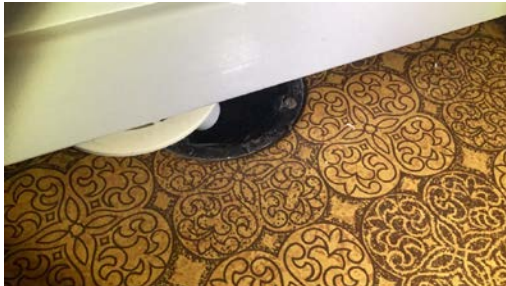
Sluk av plast med klemring.
