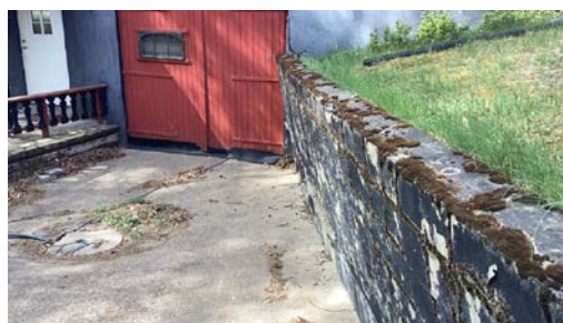
Kraftig helning på mur
