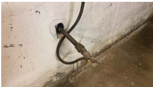
Vanninntak i garasje.
