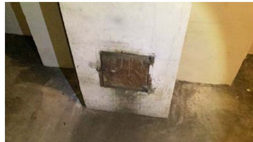
Sotluke i kjeller.
