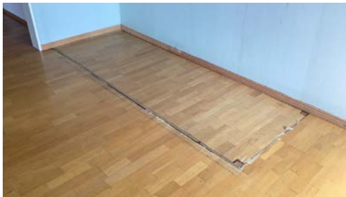
Trappeutsparing er tettet igjen
