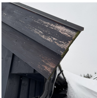
Værslitt vindskibord sørvegg
