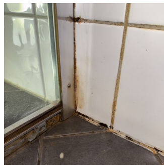
Misfargede fuger og svertesopp
