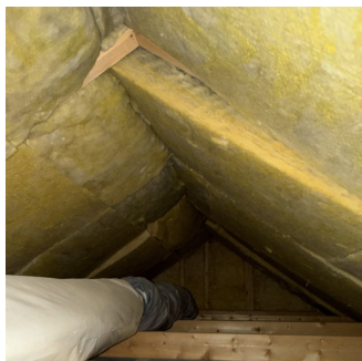
Isolasjon på øverloft er ikke festet
