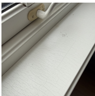
Kraketert maling på innvendig foringer
