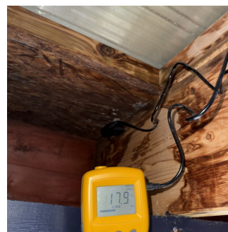
Fukt målt i taksperre og undertak
