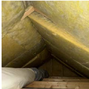
Isolasjon på øverloft er ikke festet
