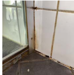
Misfargede fuger og svertesopp
