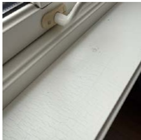
Krakelet maling på innvendig foringer
