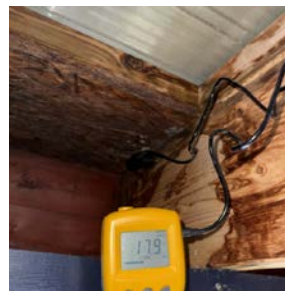
Fukt målt i taksperre og undertak
