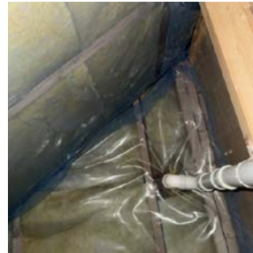
Dampsperre utett i overganger og gjennomføring av rør. Isolasjon er ikke festet.
