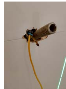
Løs ledning og usikret hull i badevegg.
