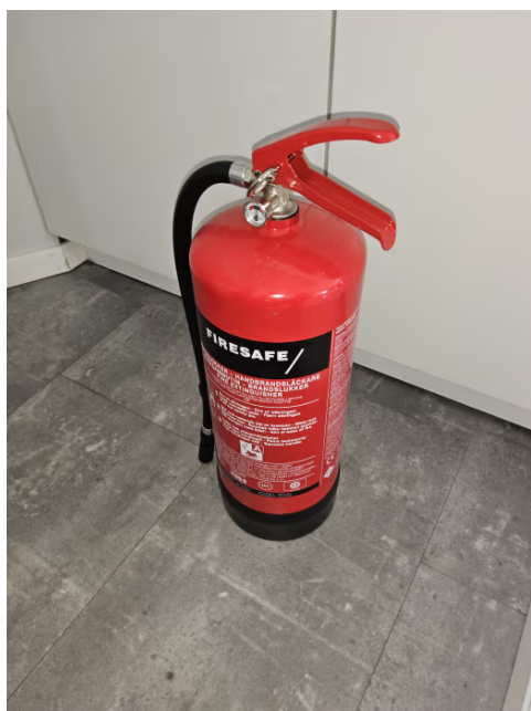
Brannslukningsapparat er sertifisert i 2024.
