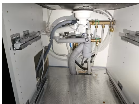
Åpen rørfordeling er plassert i kjøkkeninnredning under vasken.
