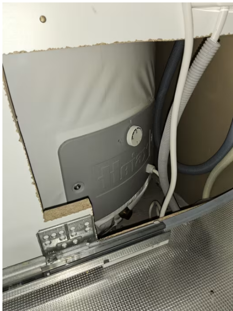
Varmtvannsbereder er innbygd i kjøkkeninnredning.
