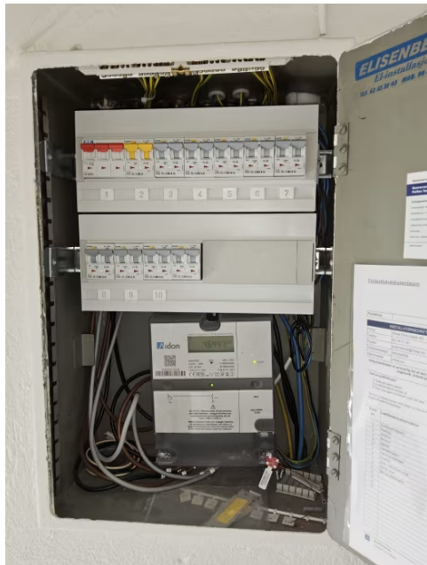
Sikringsskap er plassert i felles gang.
