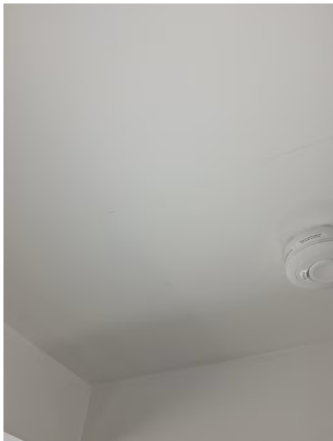
Det registreres enkelte riss i himling.
