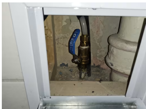
Hovedstoppekran er plassert i kasse på bad.
