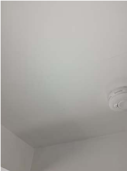
Det registreres enkelte riss i himling.
