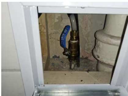
Hovedstoppekran er plassert i kasse på bad.
