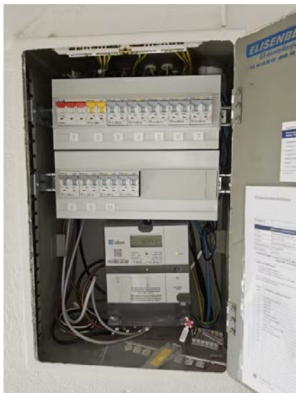
Sikringskap er plassert i felles gang.
