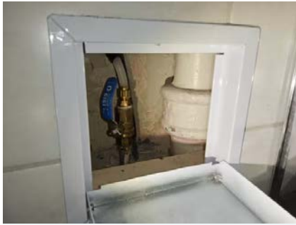
Det registreres avløpsrør av støpejern i kasse på bad.
