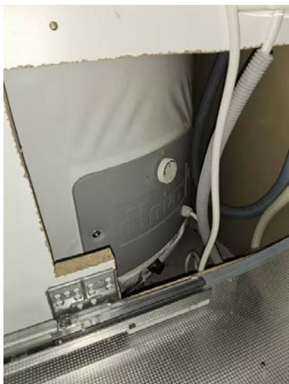
Varmtvannsbereder er innbygd i kjøkkeninnredning.
