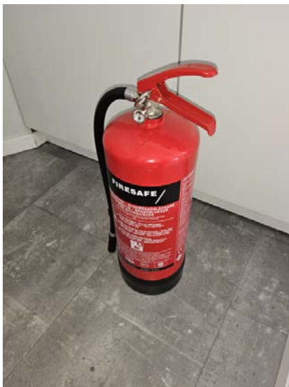
Brannslukningsapparat er sertifisert i 2024.
