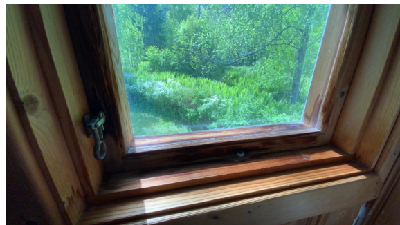
Endel fuktskjolder på vindu i bod hvor det har vært vannskade (ble ikke målt forhøyede fuktverdier på befaringsdagen).
