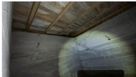
Bilde tatt fra kjeller. Det er ikke kommet til nærmere grunnet trangt hull i kjelleren.
