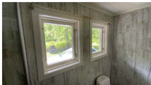
Vinduer med ukjent alder og tynnere glass.
