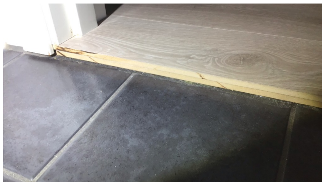
Mangler oppkant i dør
