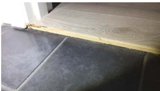
Mangler oppkant i dør
