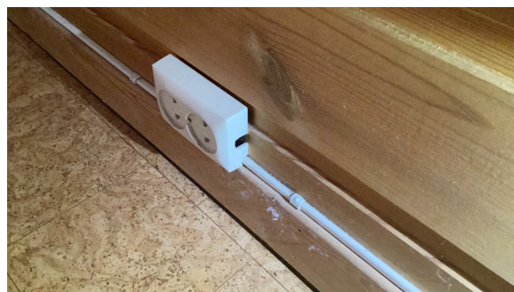
Eksempel på forhold som ville gitt avvik ved en el-kontroll.
