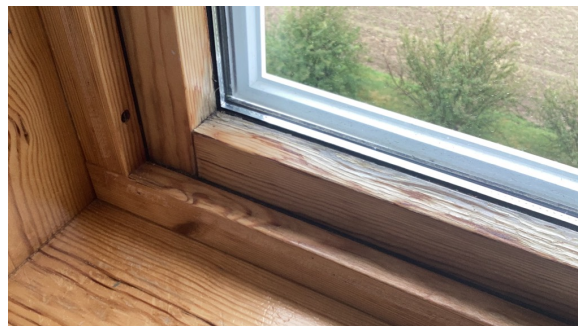
Eksempel på slitasje.
