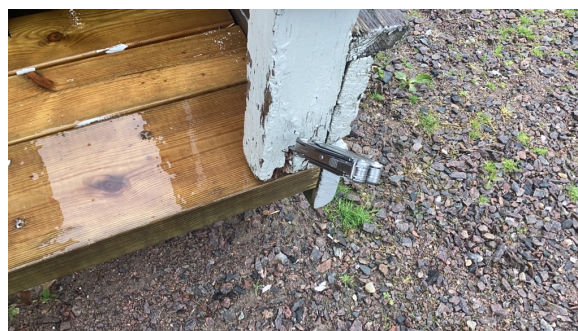
Råte i rekkverkstolpe.
