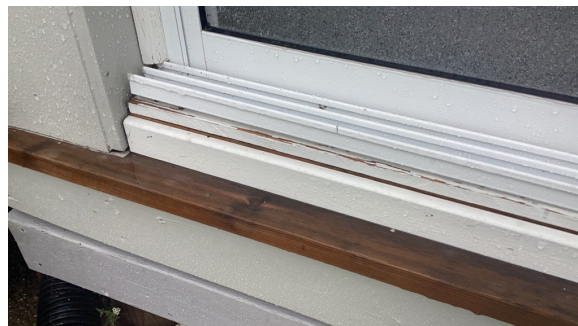
Eksempel på løsnign utsatt for fuktpåkjenninger.
