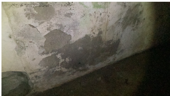
Eksempel på overflater med fuktpåkjenninger.
