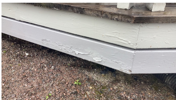
Stedvis slitasje og noe avskaling ved entre.
