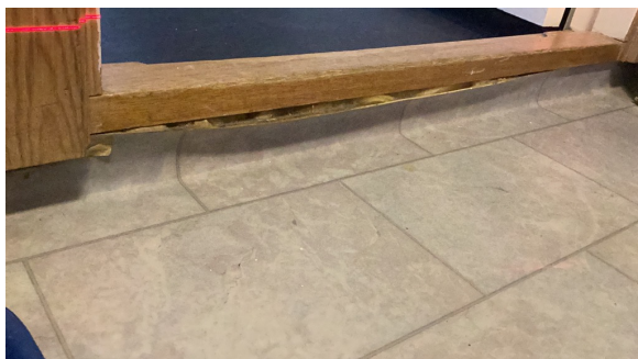
Oppbrett på belegget ved dør.
