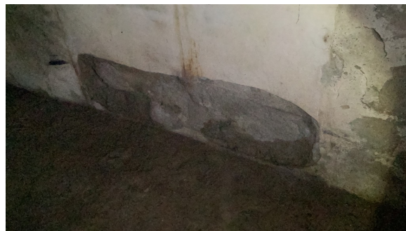
Eksempel på overflater med fuktpåkjenninger.
