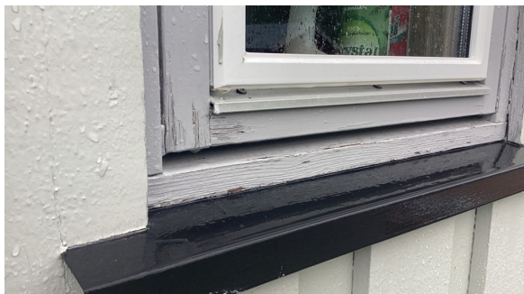
Eksempel på slitasje.
