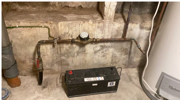
Vanninntak med måler og stoppekran.
