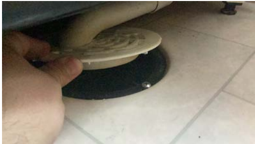
Sluk av plast med klemring.
