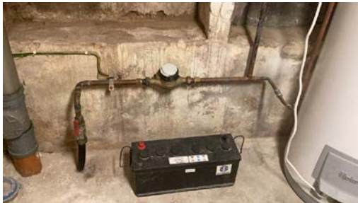
Vanninntak med måler og stoppekran.
