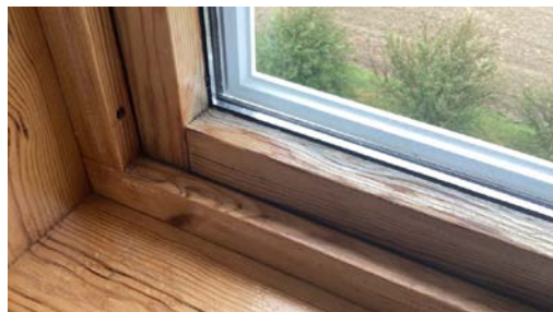
Eksempel på slitasje.
