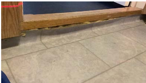
Oppbrett på belegget ved dør.
