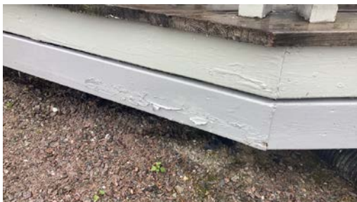
Stedvis slitasje og noe avskaling ved entre.
