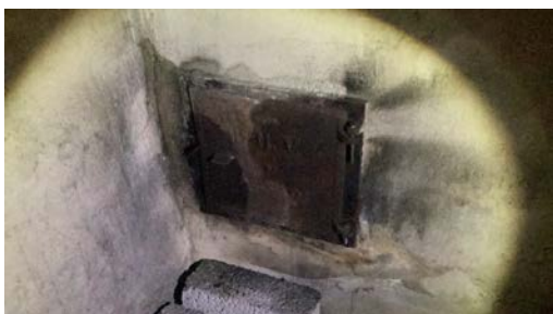
Sotluke i kjeller.
