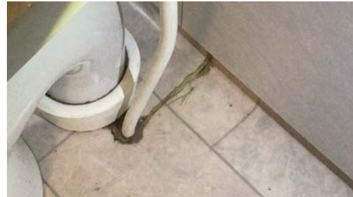
Det er utett ved gjennomføring for toalett.
