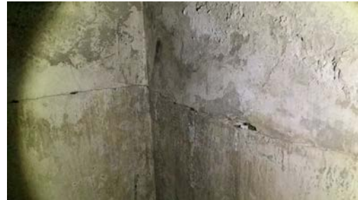
Eksempel på sprekk i grunnmur.
