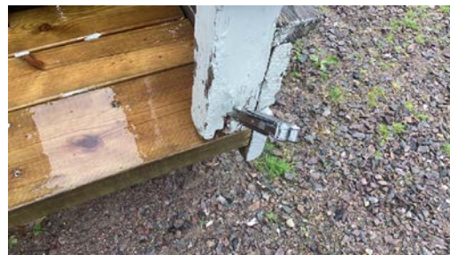
Råte i rekkverkstolpe.
