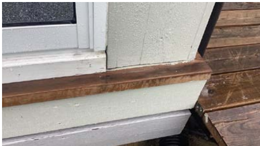
Eksempel på løsnign utsatt for fuktpåkjeni
