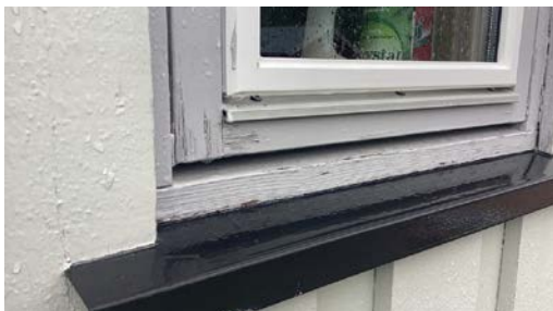
Eksempel på slitasje.
