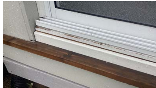
Eksempel på løsnign utsatt for fuktpåkjenninger.
