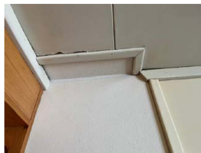
Fuktmerker ved pipe på kjøkken.
