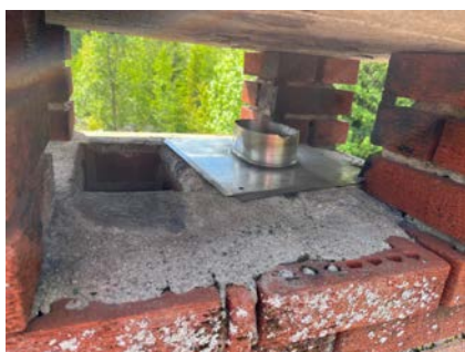
Pipe med stålrør og luftkanal.
