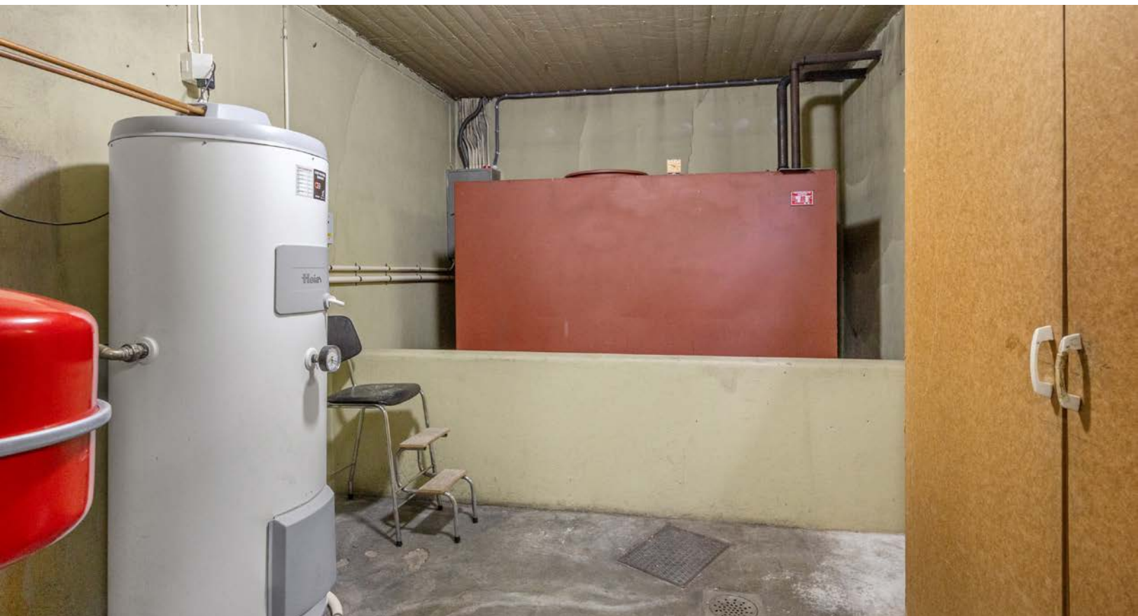
Boligen har et teknisk rom i underetasjen hvor varmtvannsberederen er plassert.
