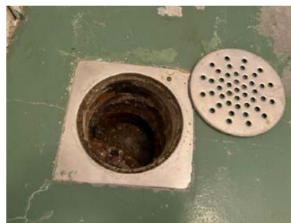
Støpejernssluk i dusjsone.
