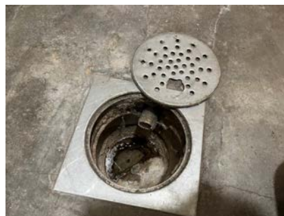
Sluk på vaskerom.
