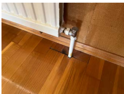
Skadet parkett ved radiator.
