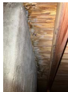
Synlige fuktmerker på underpanel ved pipejennomføring.
