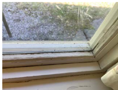
Vinduer har aldersslitasje.
