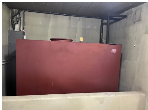
Ståltank i teknisk rom.
