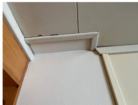
Fuktmerker ved pipe på kjøkken.
