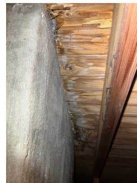
Synlige fuktmerker på underpanel ved pipegjennomføring.
