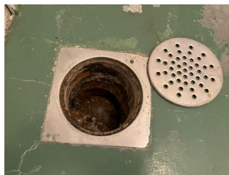
Støpejernssluk i dusjsone.
