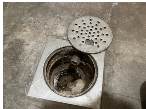
Sluk på vaskerom.
