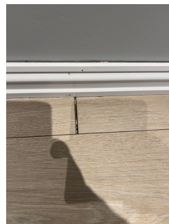
Glippe i endeskjøt. Laminatgulv.
