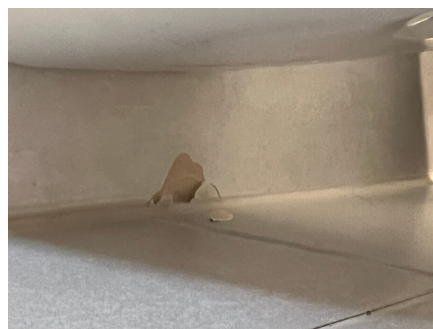
Veggflis under veggmontert toalett.
