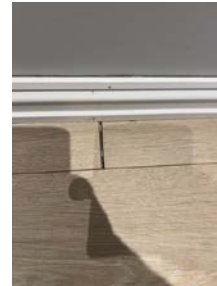
Glippe i endeskjøt. Laminatgulv.
