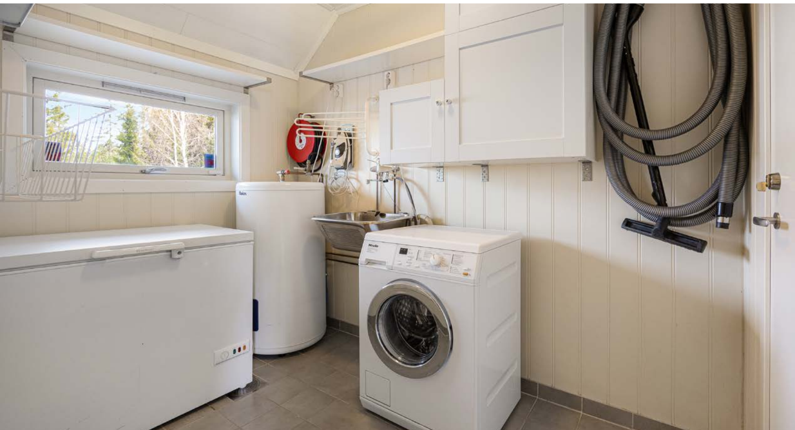
Praktisk vaskerom med opplegg for vaskemaskin og utslagsvask i stål.
