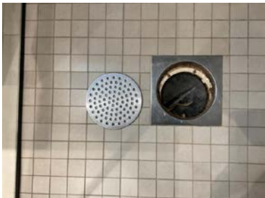
Jordingskabel ikke tilsuttet
