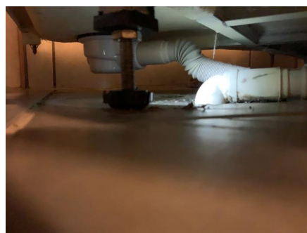
Sluk under dusjkabinett.
