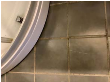
Sprekk i flis, bom i fliser og løse fuger foran dusjkabinett.
