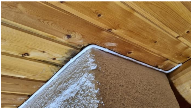
Fuktmerker ved pipen.
