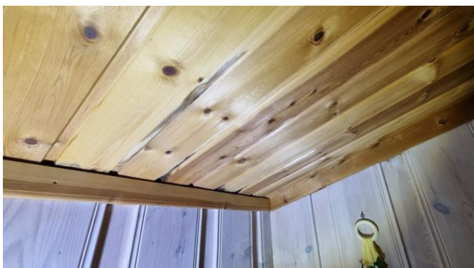
Fuktmerker i himling over kjøleskapet.
