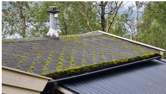
Mose i taktekket.
