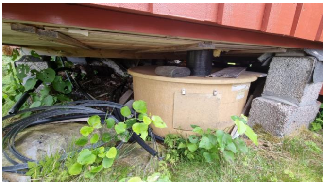
Tank under klosettet.
